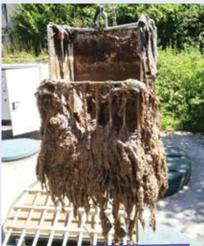
poste de relevage des Abattoirs à Montmirail service de l'eau, juin 2022
