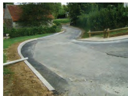
assainissement pluvial à Violaine (Verdon)
