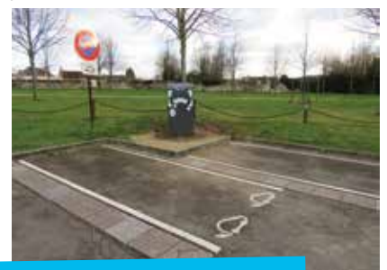
borne de recharge rue des Remparts
