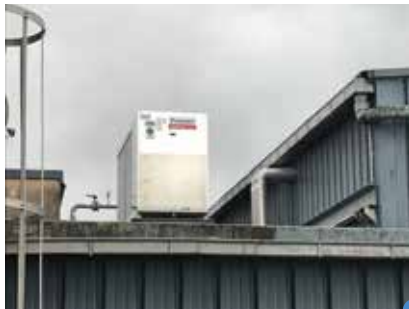
nouvelle pompe à chaleur pour le cinéma et la salle des fêtes
